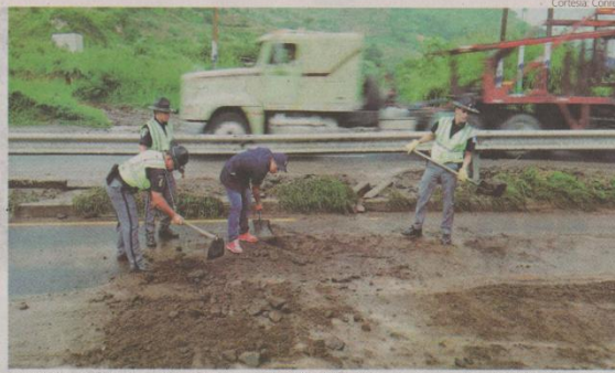
Las fuertes lluvias han causado daños en la infraestructura, así como en la agricultura y en las casas de habitación de guatemaltecos que son atendidos y auxiliados por los cuerpos de socorro.
