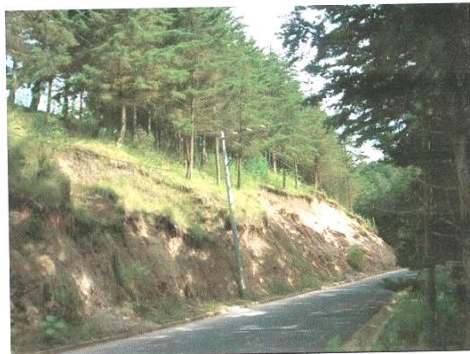
Fotografía 6 Los cortes de las carreteras han dejado vulnerables los suelos de los bosques de la Reserva.
