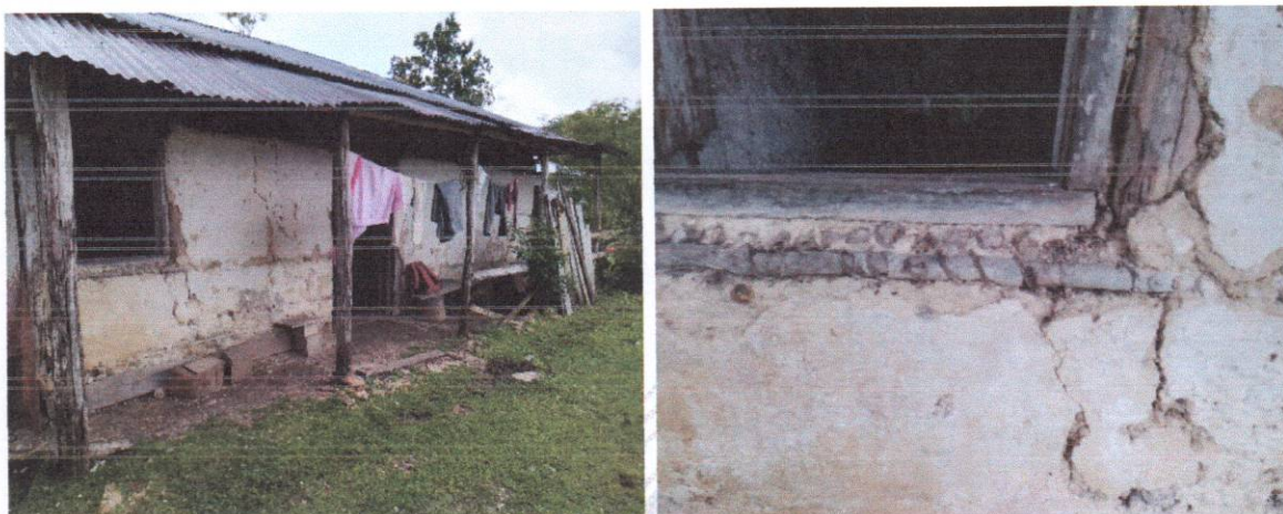
Figura 36. Casa del Señor Senen Siles obsérvese el proceso constructivo, después de 50 años.
