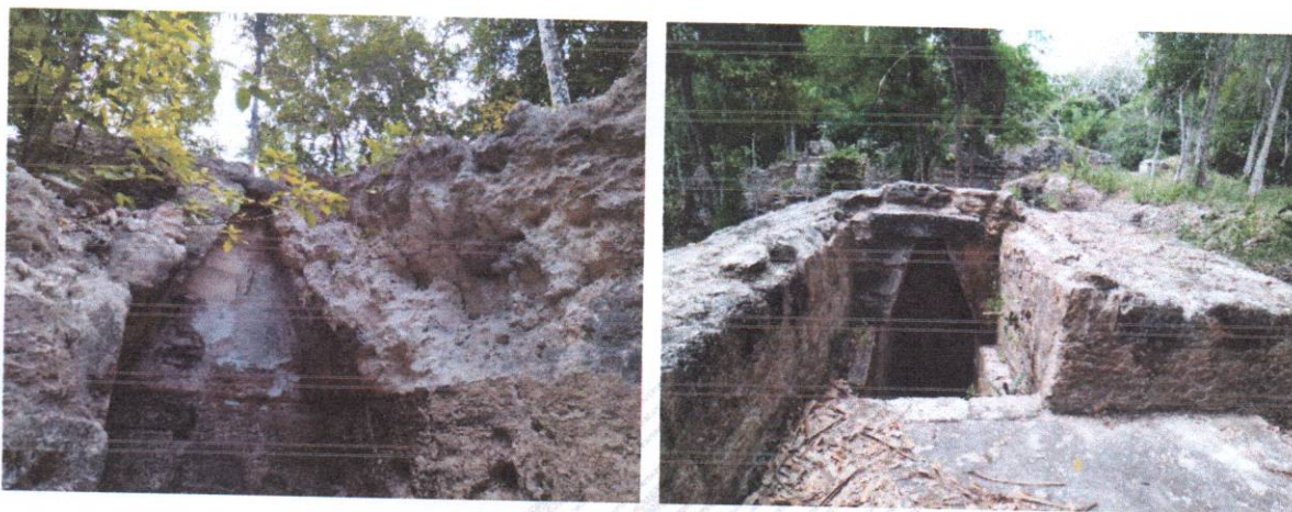
Figura 13. Fotografías del estado actual de estructuras; izq. Estructura colapsada, derecha, Estructura con problemas de colapso. Sitio San Clemente
